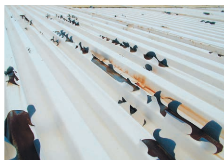
従来の防錆塗料の劣化
