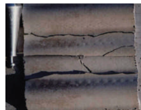
未施工スレート板
