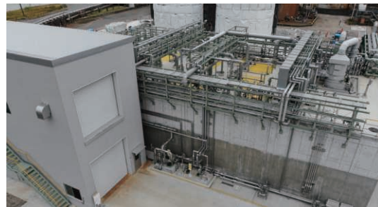
名古屋工場に新設した排水処理設備
