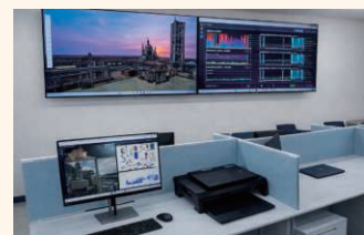
統合管理システム
