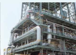
アクリル酸製造設備
