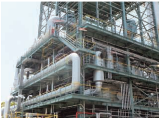
アクリル酸製造設備
