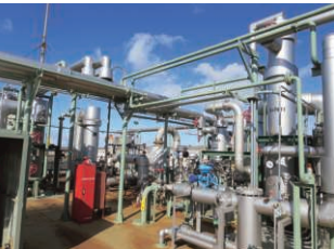
アロニックス製造設備
