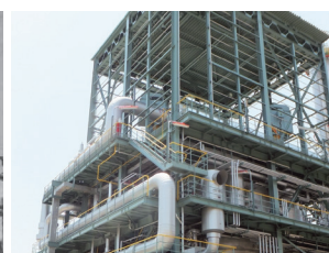
アクリル酸製造設備
