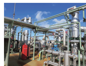
アロニックス製造設備
