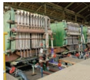
東亜合成 名古屋工場電解設備
