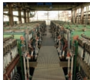
東亜合成 名古屋工場電解設備
